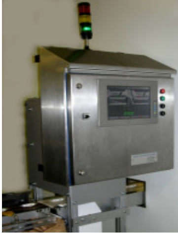
Der Schaltkasten mit Steuerrechner
